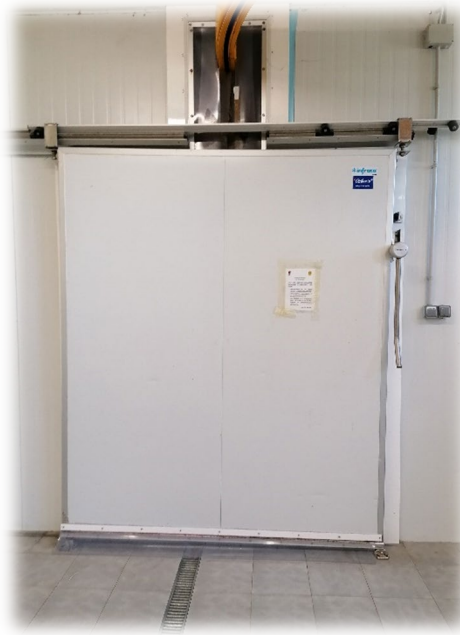
Cámara de refrigeración y congelación.
